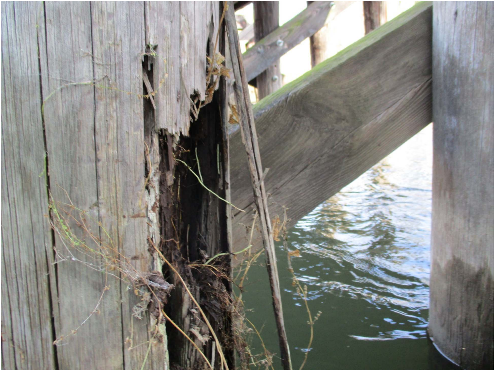
Pier 2S pile 1W rot
