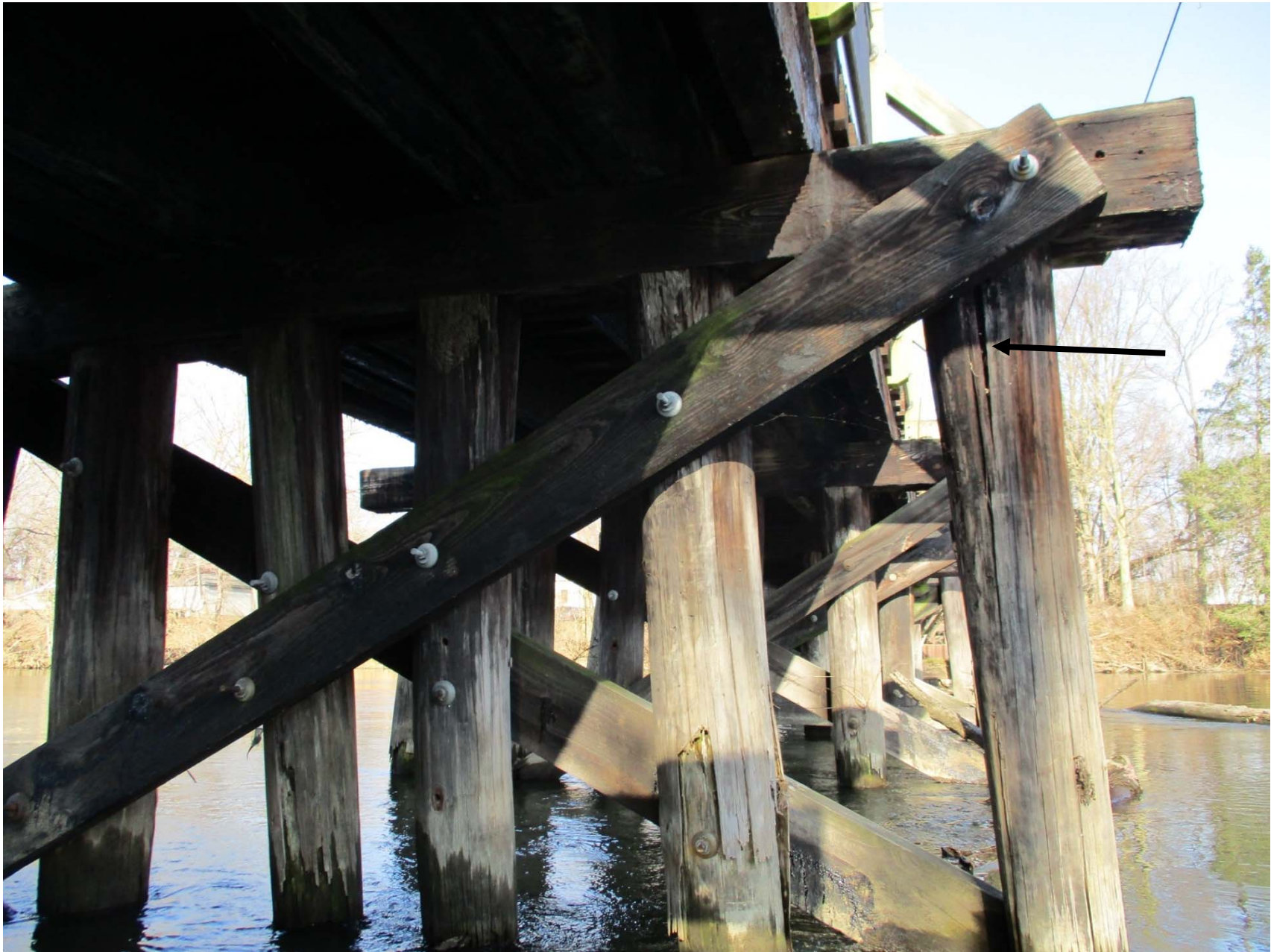
Pier 3S pile 1E split at cap
